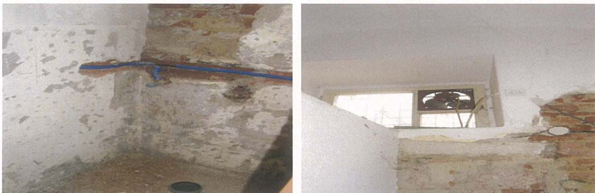
Slika 6: Strojne in elektro instalacije je nujno sanirati.
